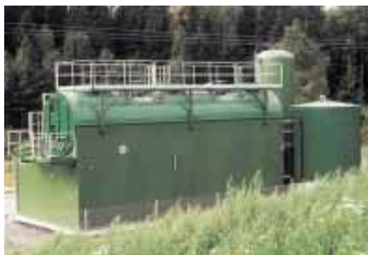
Installation de traitement de lixiviats à Kujala en Finlande (150 m 3 /jour) (Photo Hadwaco).
