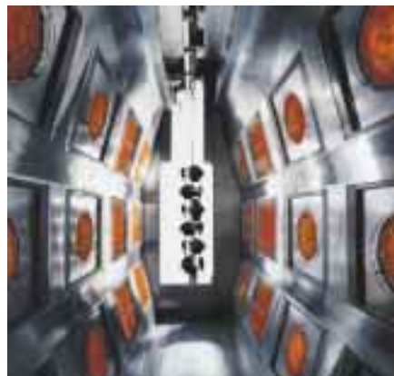
Tunnel équipé de thermoréacteurs pour le séchage de peinture PU de finition (Photo Sunkiss).
