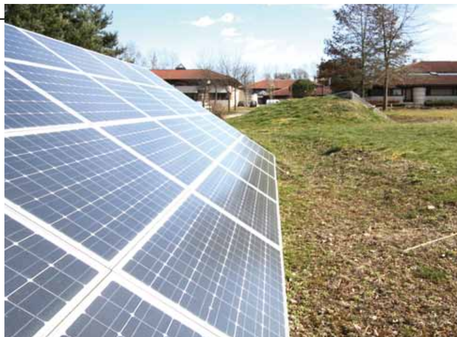
L'énergie solaire au cœur de la formation à l'IUT de Tarbes.
